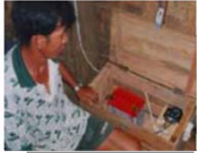
ໝໍໄຟ ແລະ ເຄື່ອງຄວບຄຸມ ຕິດຕັ້ງຢູ່ໃນກັບທີ່ປອດໄພ
